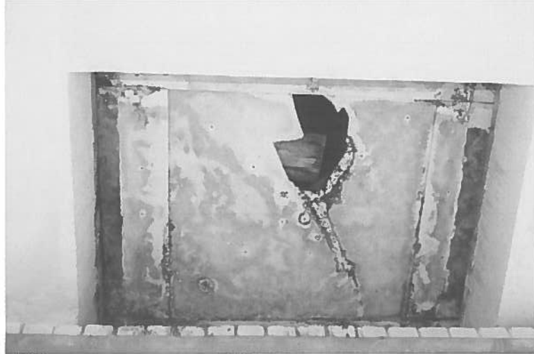
Gambar 1. Kerusakan plafon pada bagian serambi depan
