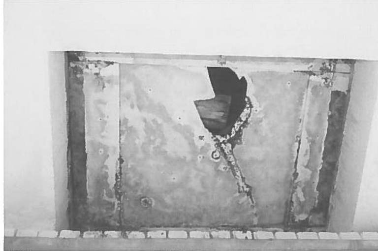
Gambar 1. Kerusakan plafon pada bagian serambi depan
