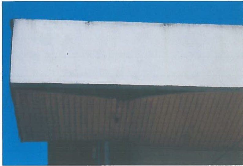
Gambar 5. Kerusakan plafon pada bagian samping belakang Gedung Gereja
