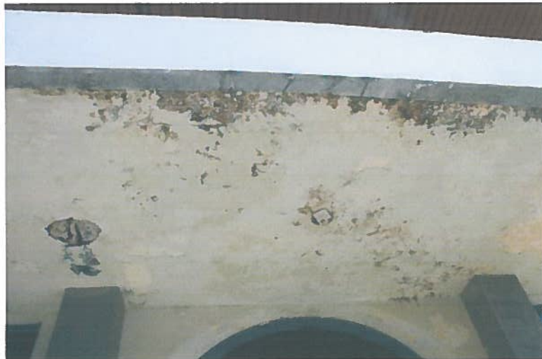
Gambar 6. Kerusakan pada atap pintu masuk bagian belakang Gedung Gereja
