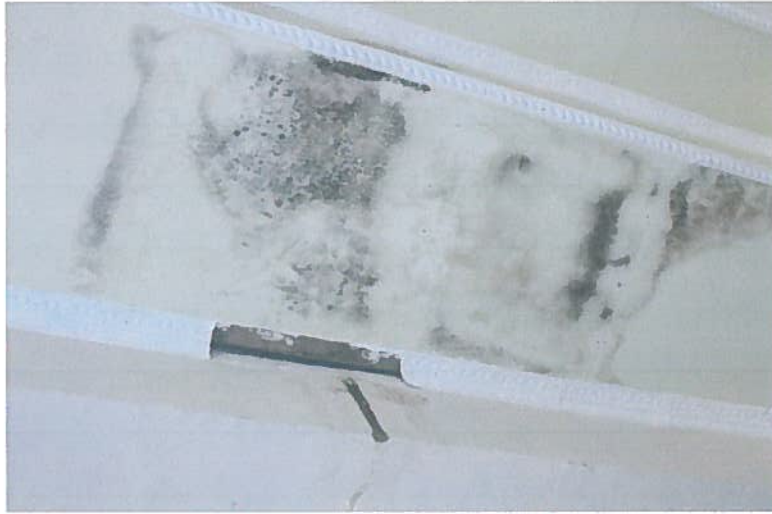
Gambar 3. Kerusakan plafon pada bagian serambi samping kanan
